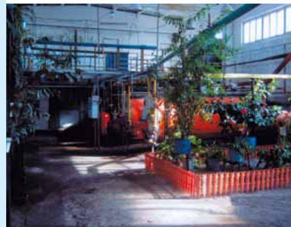
Котельная в с. Борисовском
