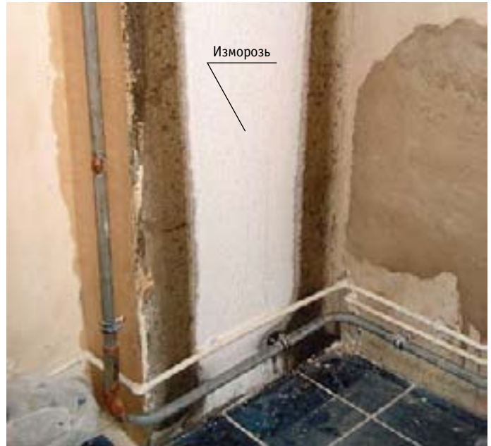
Рис. 1. Обмерзание стенок вентиляционного канала вследствие притока наружного холодного воздуха
