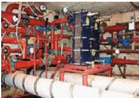
Новый тепловой автоматический узел. Общий вид. Жилой дом, ул. Рокоссовского, 6
