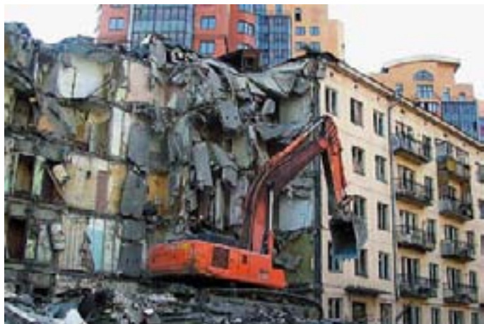
Обрушение жилого дома в Республике Казахстан
